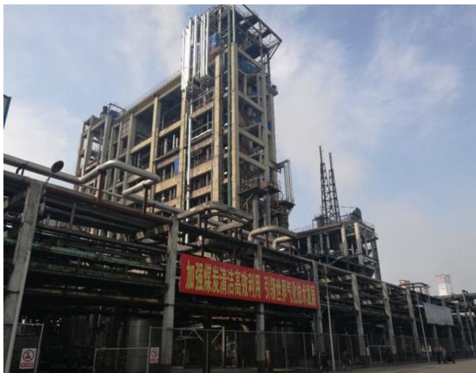
水煤浆水冷壁废锅气化炉示范装置
